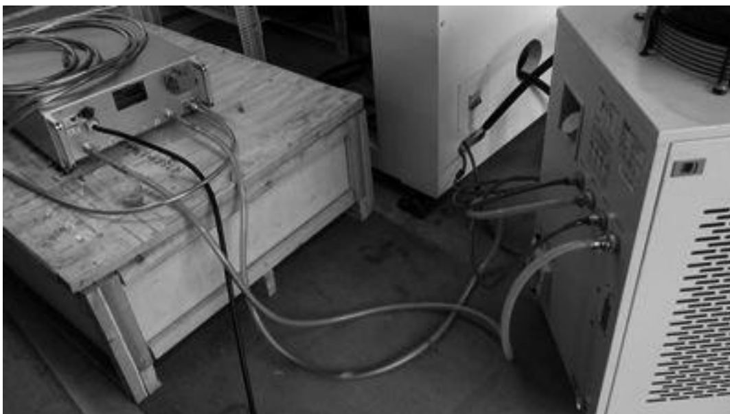
Подключение чиллера к оптоволоконному источнику
